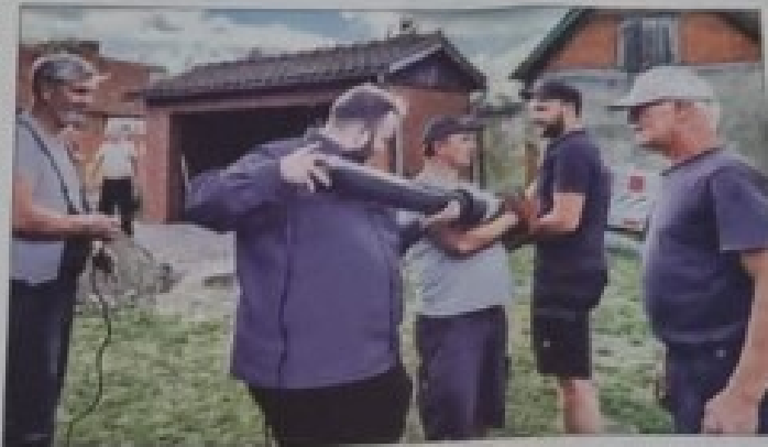
Die neue Solarlampe wird installiert. Auf dem Platz vor dem Buswartehäuschen in Schernebeck montieren Fachleute am Donnerstag den Akku für die Solarlampe.
